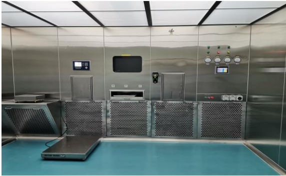
房间内除尘设备
